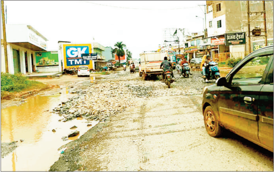
जर्जर सड़क के गड्ढे एवं जगह-जगह जमा पानी।
